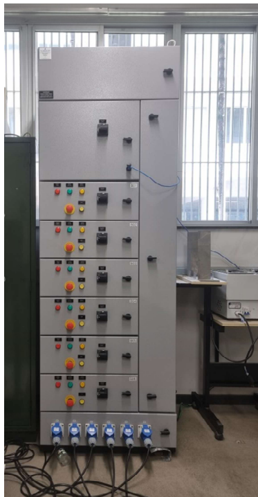
Figura 2 – Vista frontal do CCM, sala 1205 do Lab. Automação.
